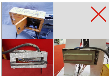
电箱必须完好且有漏电保护开关并保持箱门关闭，安装须离地30厘米。
