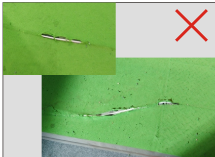
展位地面线路未使用线槽：不合格
