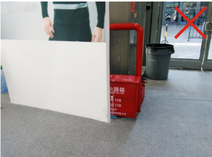
严禁遮挡消防设施
